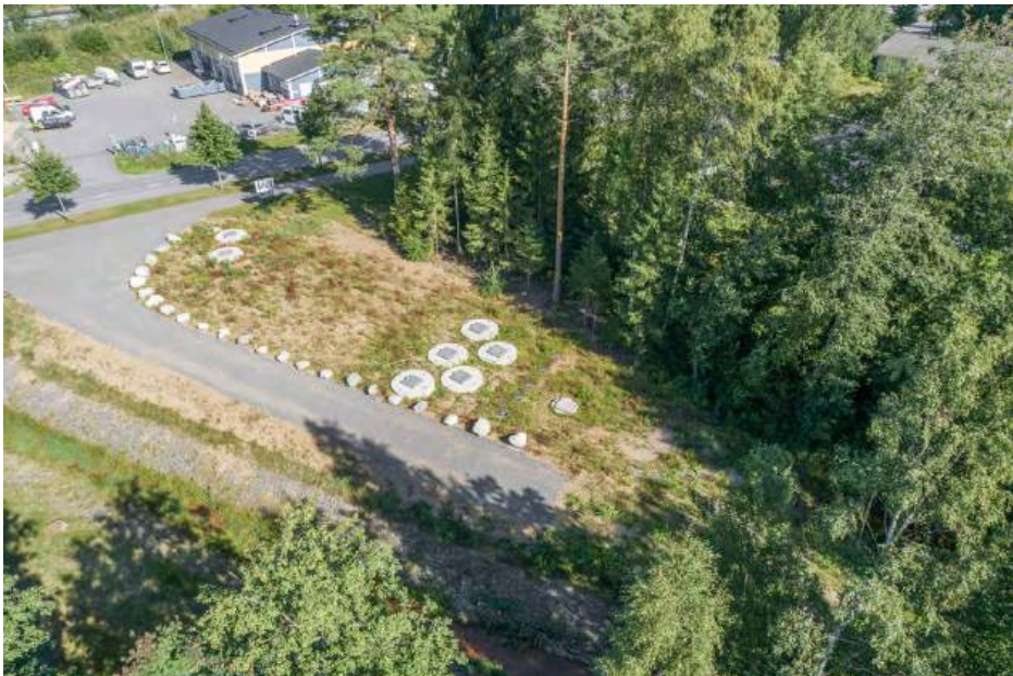
KUVA 2. Pitkäljärven hulevesien käsittelyjärjestelmä. Kuvassa näkyvät viisi rinnakaista kaivoa sisältävät itse suodatinmateriaalit (kuva Juha Vihavainen).
