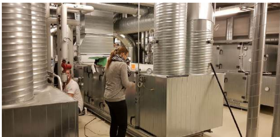
KUVA 5. Karhulan uimahallin poistoilmakone, johon pilotoidaan lisälämmöntalteenotto lämpöpumpputekniikalla (kuva Tuija Korpela).
