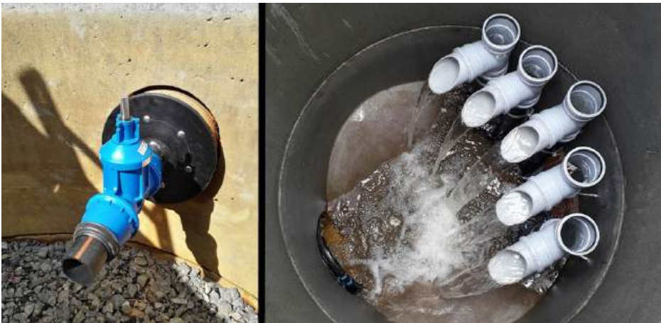
KUVA 2. Pitkäjärven hulevesijärjestelmän kevään 2020 muutostöiden tuloksia. Vasemmalla suodatinkaivoissa oleva säätöventtiili, josta tulovirtaamaa voidaan säädellä kaivokohtaisesti. Oikealla kokoojakaivosta kaikkien viiden suodatinkaivon korotetut poistoputket, jotka estävät vesien sekoittumisen ja mahdollistavat helpomman tutkimustyön. (kuva Aki Mykkänen)
