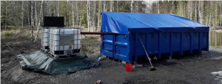
KUVA 5. Kevään 2020 muutostöiden jälkeinen Ristiinan vanhan kaatopaikan biosuodatuslaitteisto. Vasemmalla kaksi IBC-konteista tehtyä esiselkeytysallasta. (kuva Aki Mykkänen)
