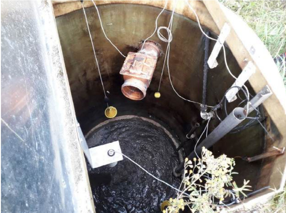
KUVA 1. Jäteveden monitorointia tehdään pumppaamoissa (kuva Riina Tuominen).
